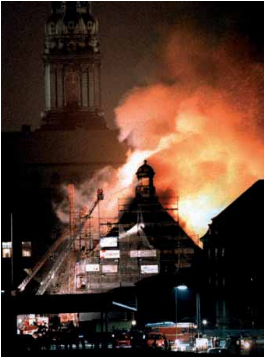
Under istandsættelsesopgaver i Proviantgården udbrød en storbrand den 9. februar 1992. Branden truede med at brede sig til både Christiansborg Slot, Rigsarkivet og Den røde Bygning, inden den blev slukket (Polfoto).
